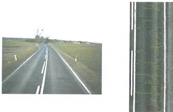
Rys 3. Zdjęcie poglądowe ze zdjęciem z zaznaczonymi uszkodzeniami nawierzchni.
